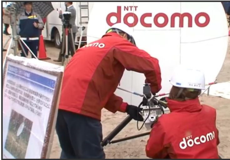
孤立地域エリア救済のための 可搬型衛星基地局設営訓練
