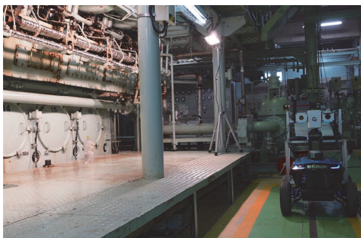
写真2 巡視点検ロボットにて漏油・漏水を検知する様子
