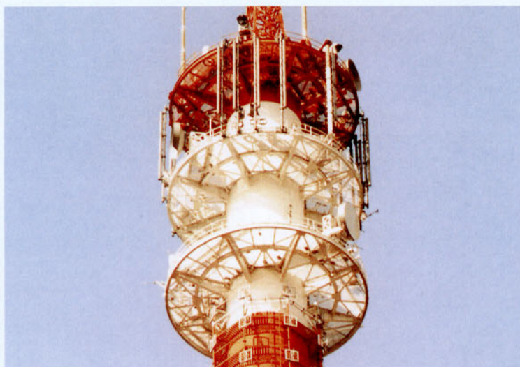
写真1 基地局アンテナ群
