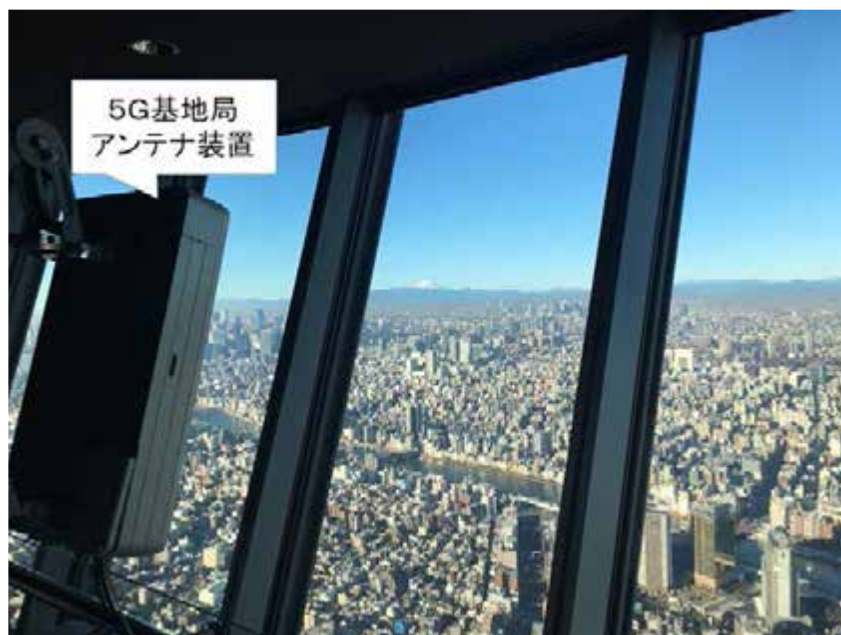
5G基地局装置(東京スカイツリー天望デッキ)
