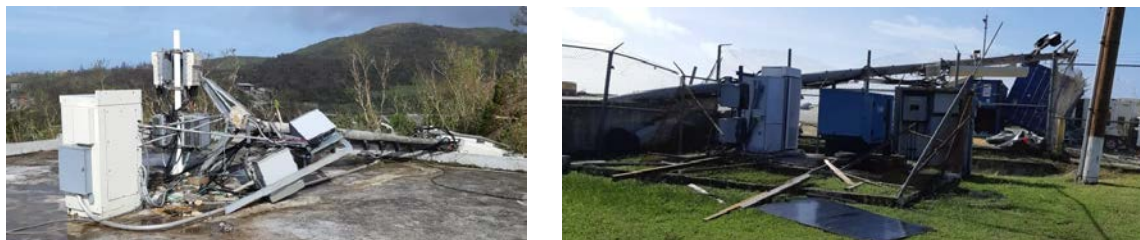
図2. 2018年10月、マリアナ諸島を襲った台風26号により被災したドコモパシフィックの基地局設備
