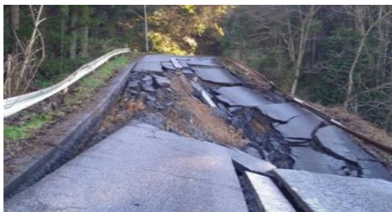
陸路損壊 / 津波被害
